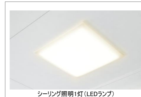
シーリング照明1灯(LEDランプ)
